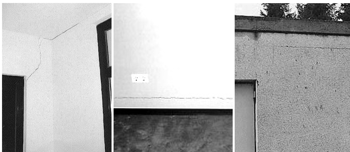
Abb. 2.1: Typische Schadensbilder nach [Brand/Glatz – 05]. Links: Risse in einer leichten Trennwand infolge Durchbiegung der Deckenplatte. Mitte: Horizontalriss in der Wandscheibe durch Muldenbildung der unteren Deckenplatte. Rechts: Horizontalriss in der Außenwand infolge Auflagerverdrehung
